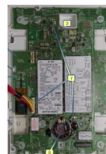
故障した基板のみ
